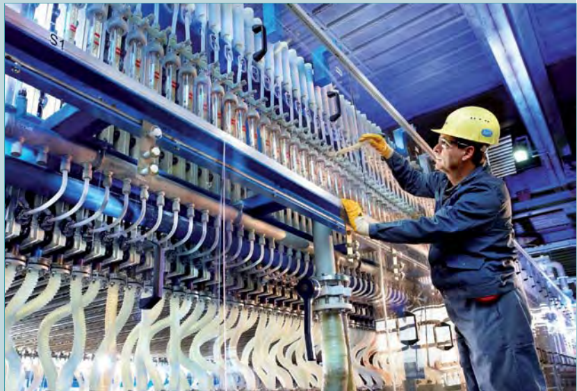
Kontrolle des Natronlauge-Zuflusses zum Sauerstoffverzehrkathoden-Element in der Chlorproduktionsanlage
