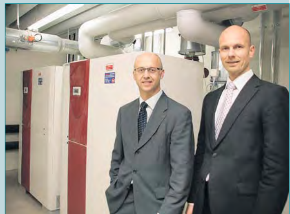
Hans-Peter Frei und Dr. Rainer Frei vor der neuen Heizzentrale mit Wärmepumpen
