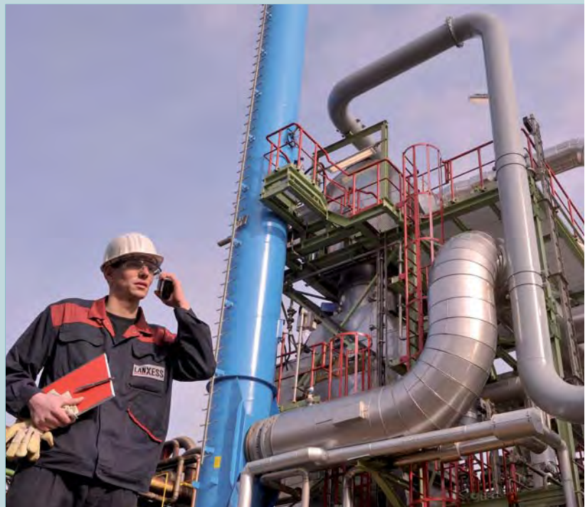
Lachgas-Reduktionsanlage am Standort Krefeld
